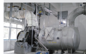
福建某造纸厂智能真空透平系统
